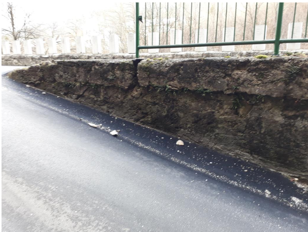
Poškodba na začetku opornega zidu
