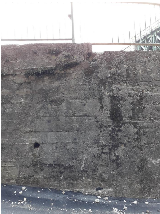
Razpadanje opornega zidu – spodnji del
