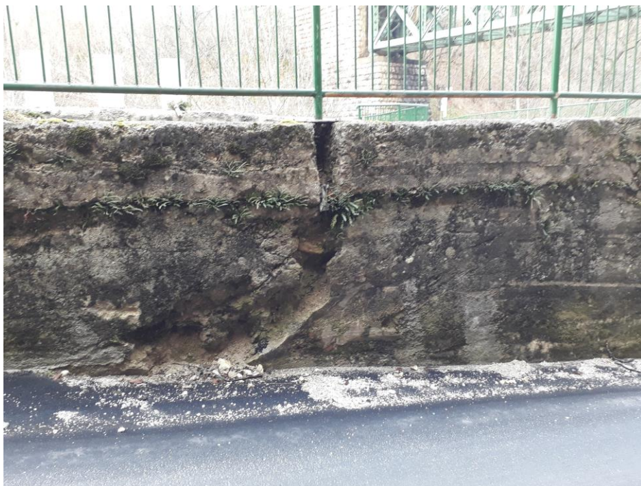
Poškodba na srednjem delu opornega zidu
