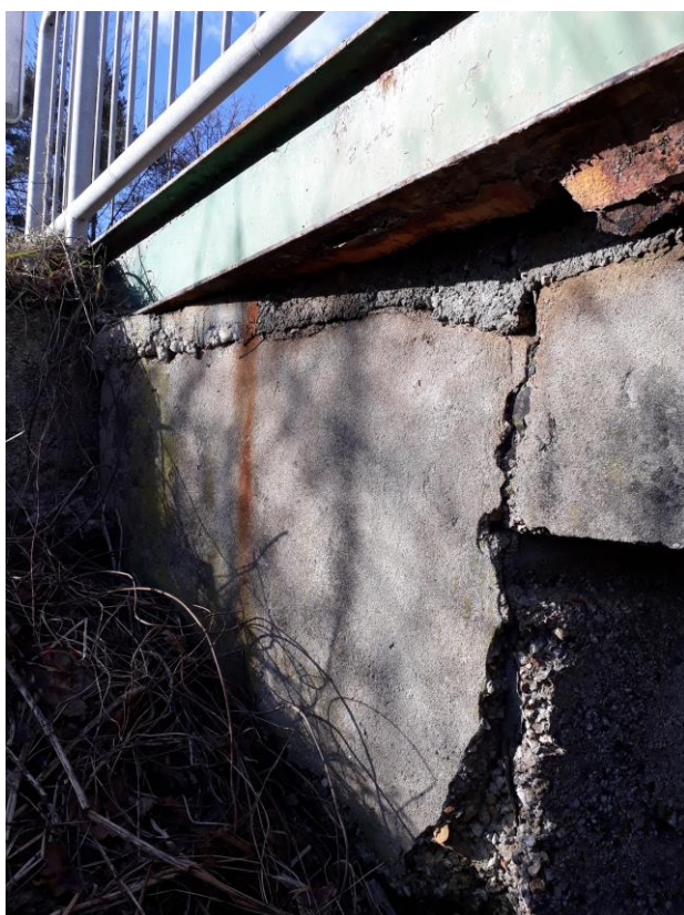
Razpoke na jugo vzhodnem delu propusta
