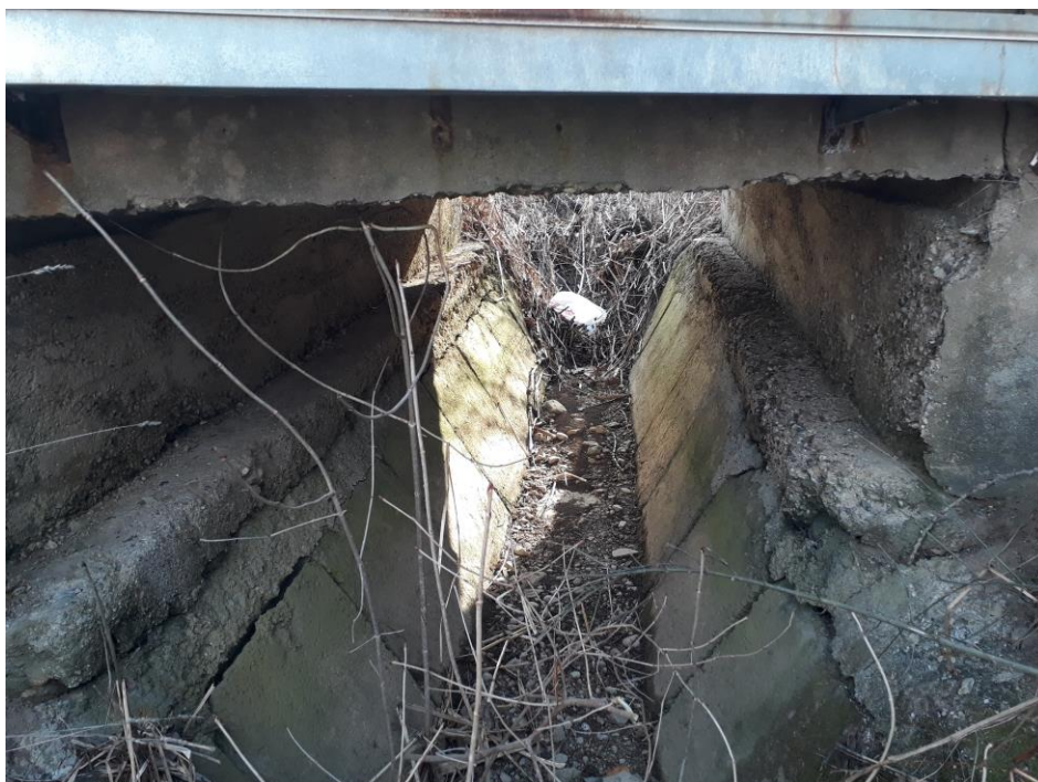
Poškodovana konstrukcija na zahodnem delu propusta
