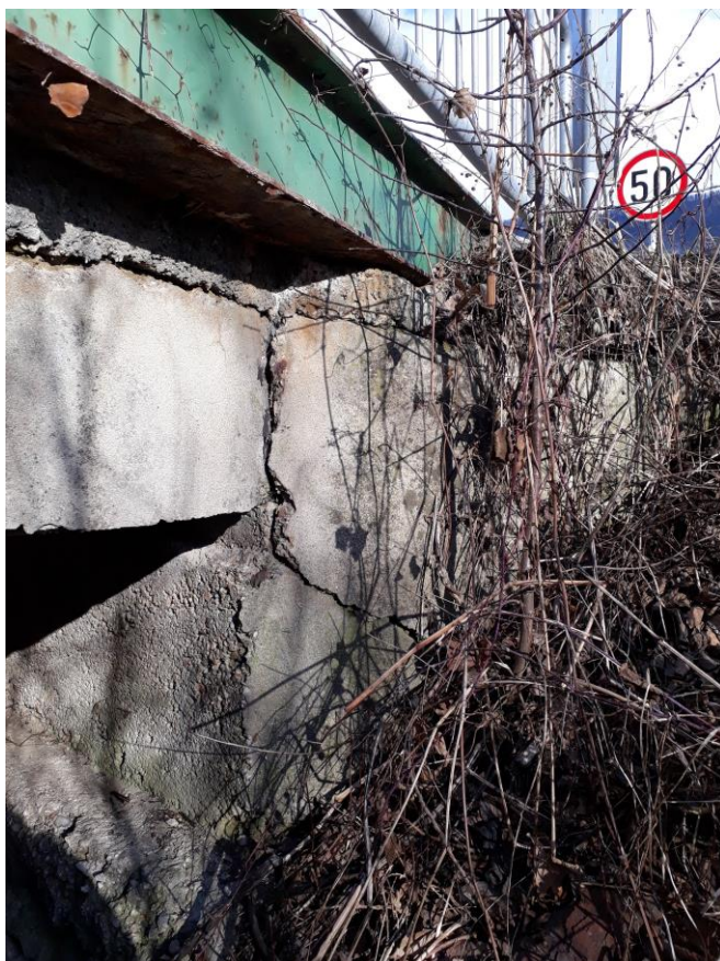
Razpoke ob oporniku ob severo vzhodnem delu propusta
