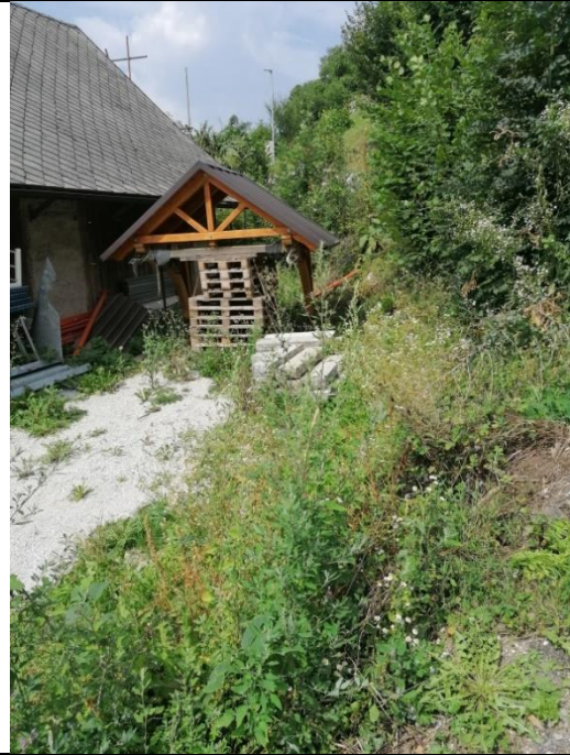
ZARASČEN IN RAZPADAJOČ OPORNI ZID POD CESTO V SMOKUČU
