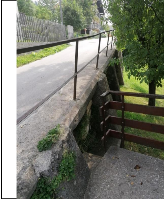
NAGIBAJOČ OPORNI ZID V ŽIROVNICI
