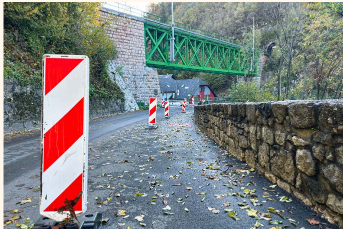
Omejen promet zaradi spodjedene opornega zidu
