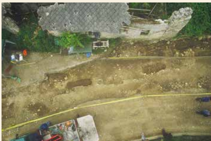
Nekoč gradnja in danes rušitev gospodarskega poslopja Smokuč 21 sta močno posegli v grobišče. Foto Milan Sagadin.
