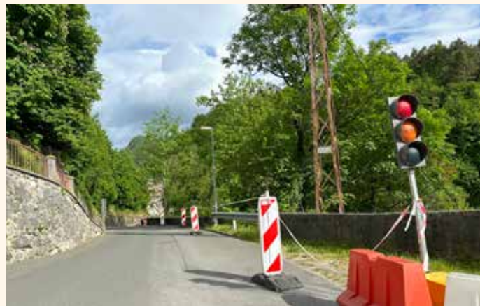
Promet nad poškodovanim opornim zidom zaradi varnosti poteka enosmerno.
